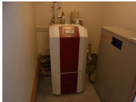
住宅の中の地中熱ヒートポンプボイラー
