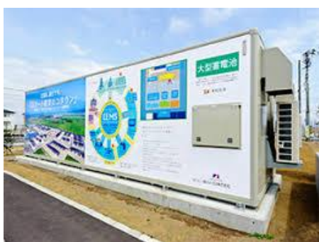
■蓄電池、CEMS コンテナ
